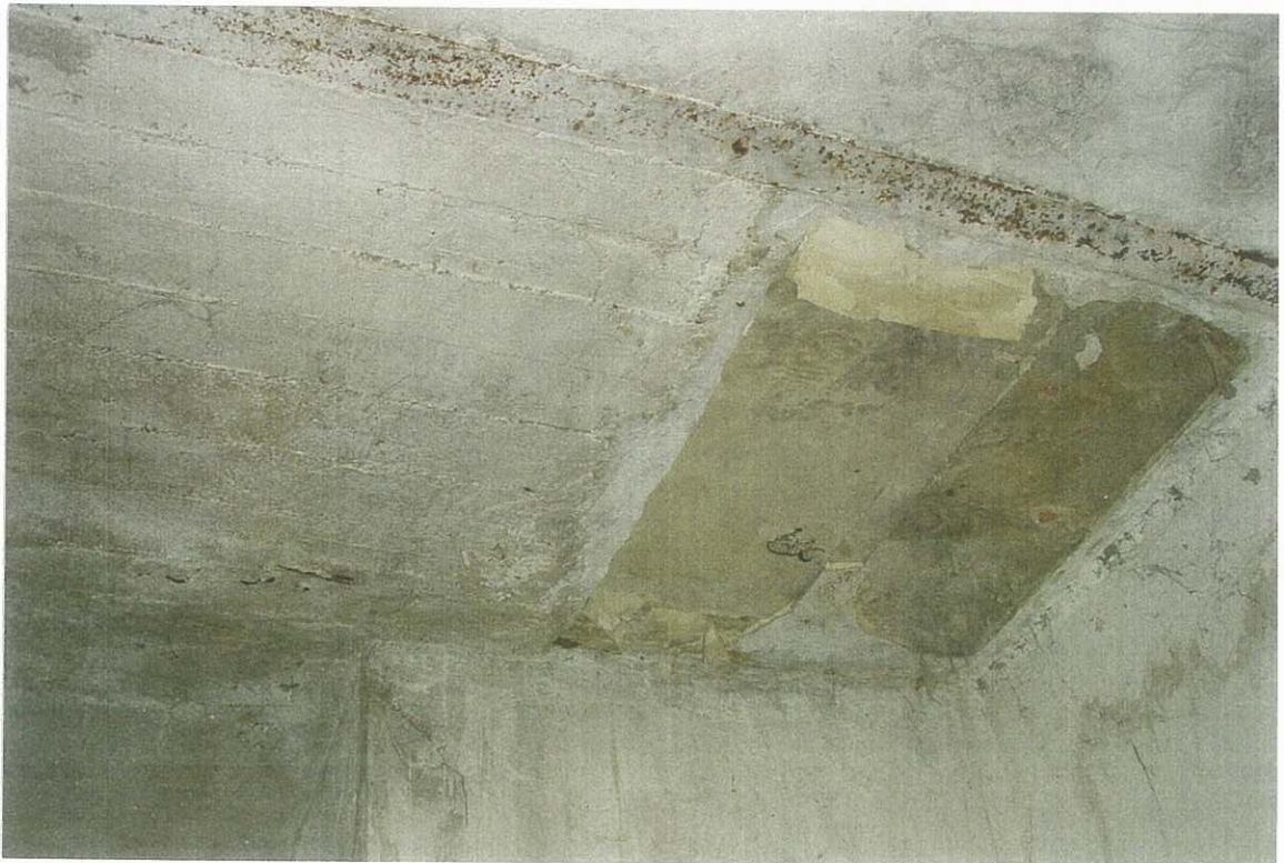
Fot. nr 10. Wyraźne ślady zawilgocenia stropu w dawnym magazynie opału. Korodująca belka stalowa.
