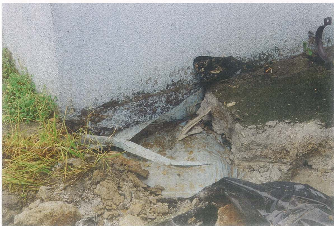
Fot. nr 4. Uszkodzona opaska betonowa na ścianie wykusza od strony płn.
