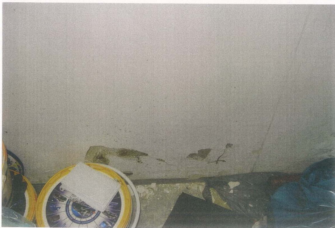
Fot. nr 18. Zawilgocenie ściany piwnicznej w części korytarza przy pomieszczeniu węzła cieplnego.
