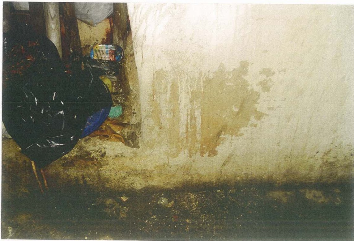
Fot. nr 20. Zawilgocona ściana i posadzka w pomieszczeniu dawnego zsypu.
