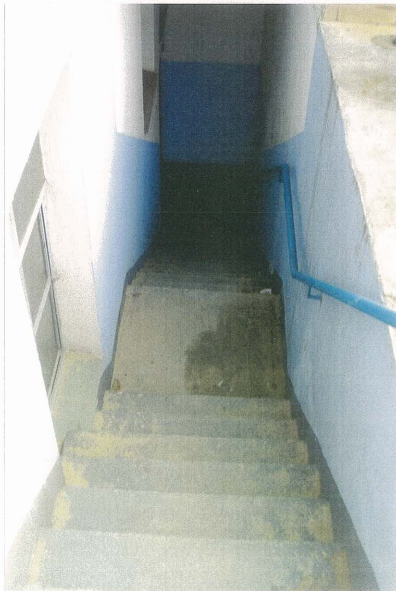
Fot. nr 34. Wejście boczne do kotłowni. widoczne zawilgocenia podestu i ściany zewnętrznej. Brak kratki odwadniającej podest wejściowy.
