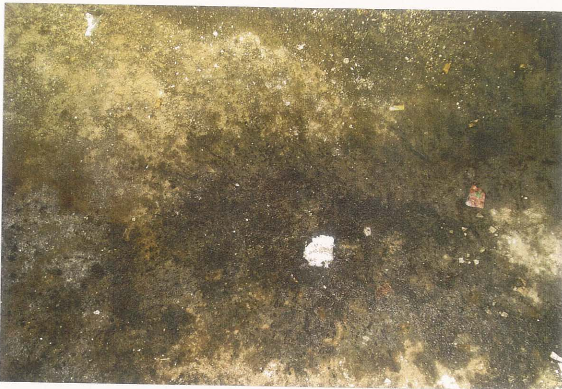
Fot. nr 19. Zawilgocona posadzka przy pomieszczeniu zsypu opału.
