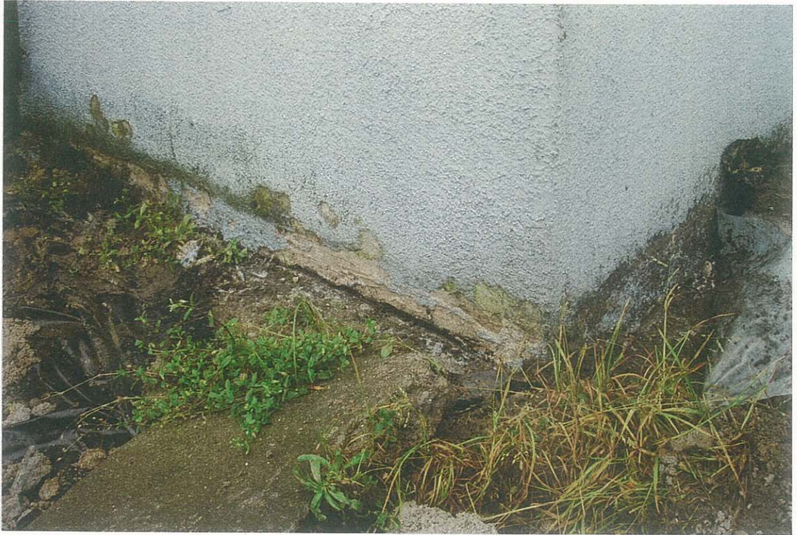
Fot. nr 9. Elewacja pn., ślady zawilgocenia tynku. Brak opaski przy ścianie.
