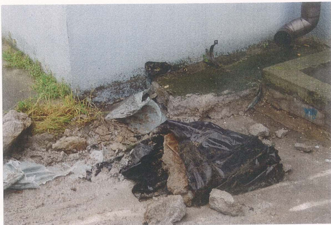
Fot. nr 3. Uszkodzona opaska betonowa przy narożu wykusza od strony płn.-zach. Widoczna folia PE zalegająca pod opaską i brak opaski przy fragmencie płn. ściany.
