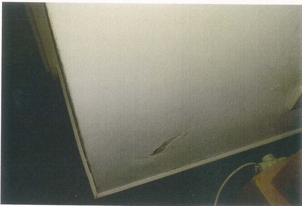
Fot. nr 23. Zawilgocona ściana wewnętrzna między korytarzem a pomieszczeniem węzła cieplnego.
