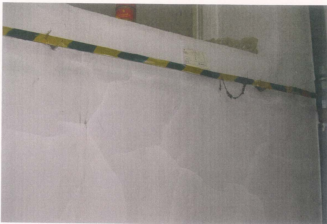
Fot. nr 17. Widok zarysowanego tynku na ścianie podokiennej w części korytarza prowadzącego do pomieszczenia węzła cieplnego. Ściana zewnętrzna zach. od strony wejścia do piwnicy.
