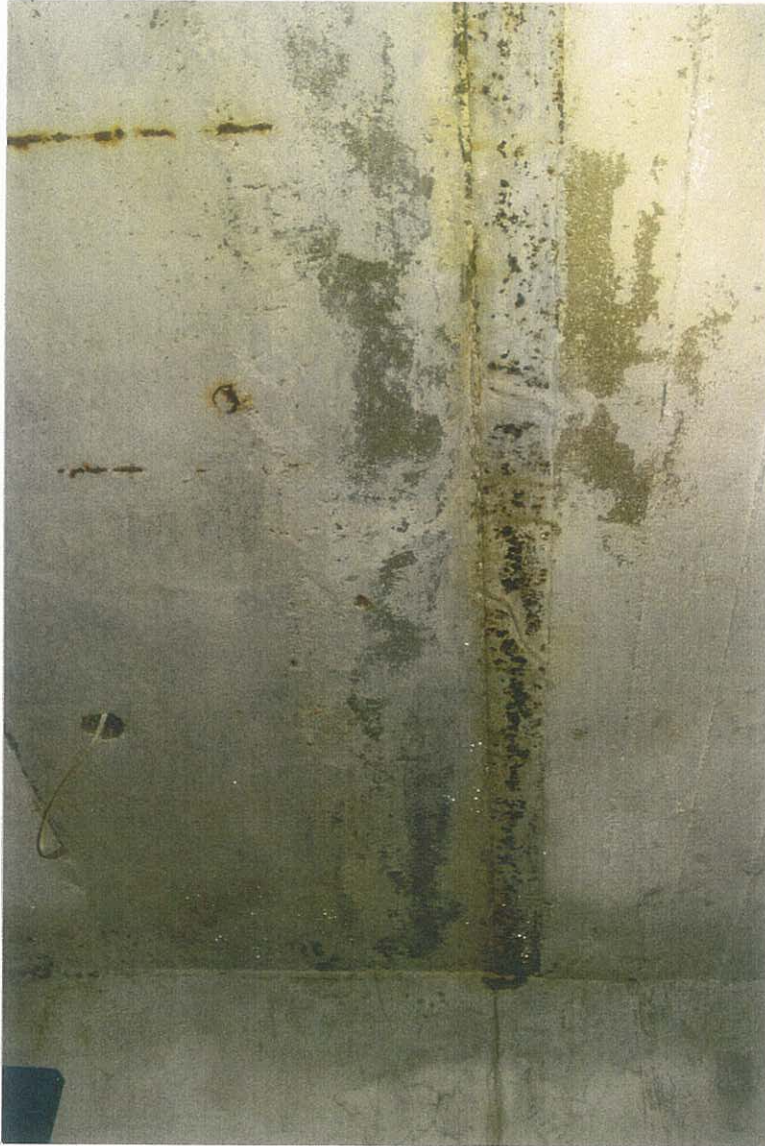
Fot. nr 21. Zawilgocony strop, korodujące belki stalowe.
